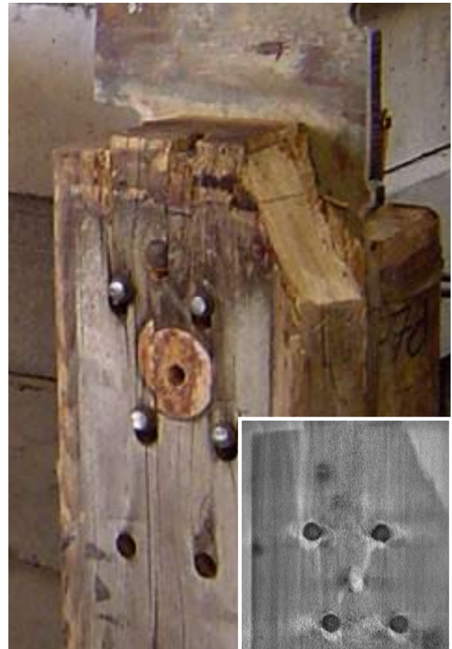
Neutronentomographie (rechts) für das hölzerne Verbindungselement mit Stahlplatte und Bolzen (links). Die hölzernen Strukturelemente senkrecht zur eingelassenen Stahlplatte sind gut zu erkennen.
